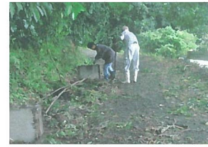
台風後の現場確認及び泥上げ
