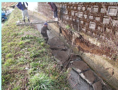
補修が必要な水路
